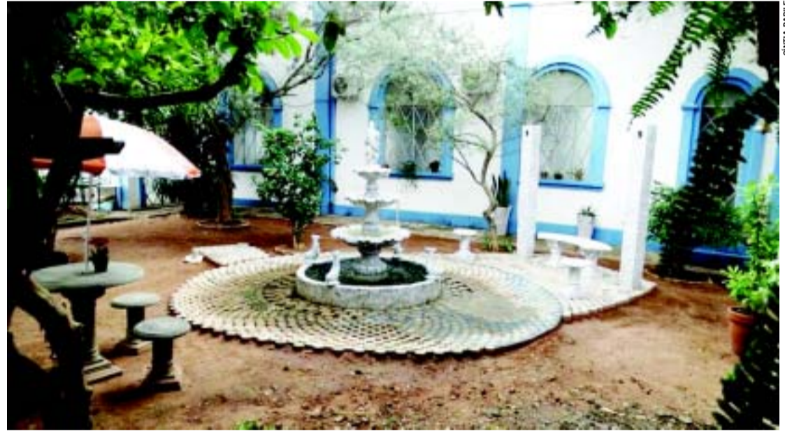
Claustro está em reforma, o chafariz foi construído com as medidas Fibonacci, as medidas áureas
